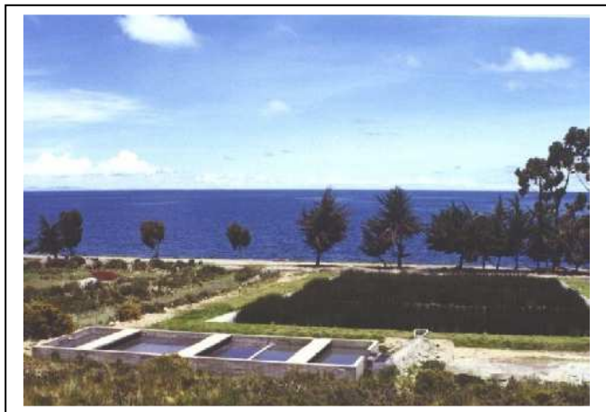
Abbildung 4: Die MEDMIN-Abwasseraufbereitungsanlage in Copacabana, Titikakasee, Bolivien. Links der Sedimentationstank ( \tau \approx 8.5d ), im Hintergrund die drei biologischen Reinigungskammern ( \tau \approx 17h ).
