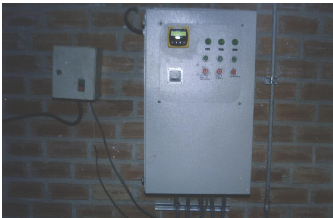
Figura 22: La panel de control de pH por el cual se maneja continuamente la dosificación de la lechada de cal.
