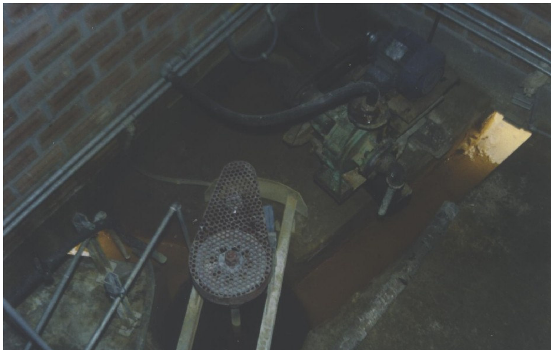
Figura 21: La planta de calef, donde se mezcla el DAR con la solución de cal altamente alcalina, iniciando de esta manera el tratamiento químico.
