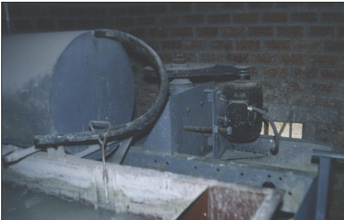
Figura 20: El tanque de caleó, donde se mezcla el cal crudo con agua natural para después añadir a el DAR saliendo de la Mina Santa Catalina.
