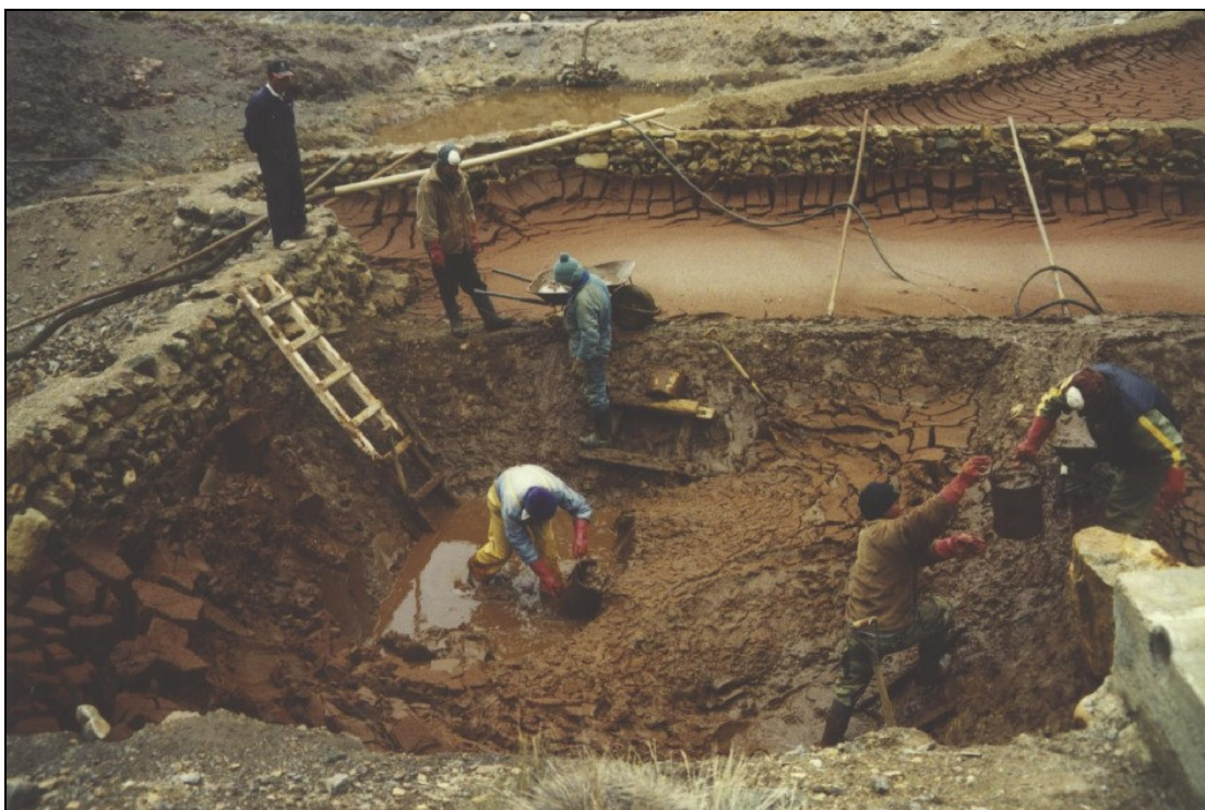
Figura 26: Los tanques de de evaporación para los lodos (uno de los puntos todavía críticos en el proceso de tratamiento) durante su evacuación.
