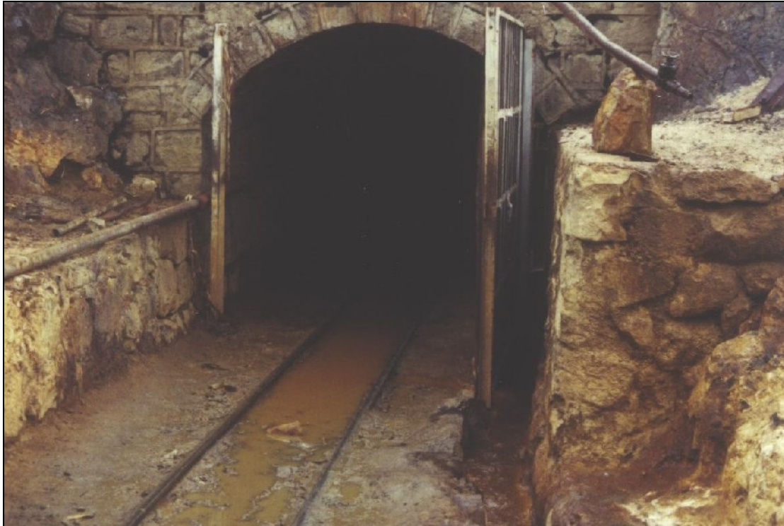
Figura 19: El socavón de la Mina Santa Catalina con los drenajes ácidos en la parte derecha del carril.
